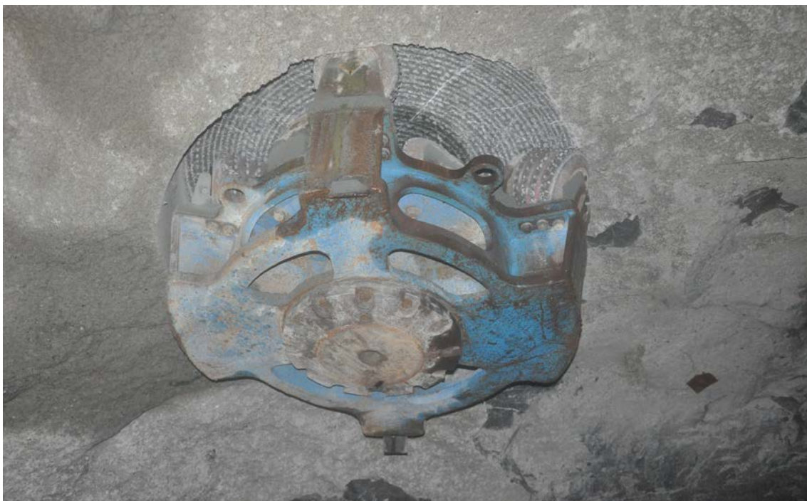
Abb.2: Beginn der Aufweitung einer Raisebohrung im Scheelitbergbau Mittersill der Wolfram Bergbau und Hütten AG
